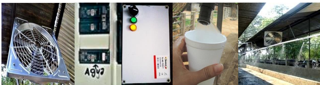
Figura 3. Sistema de tratamiento de estrés calórico: ventilador, interruptor térmico, panel de control y medición de volumen de caudal del aspersor
