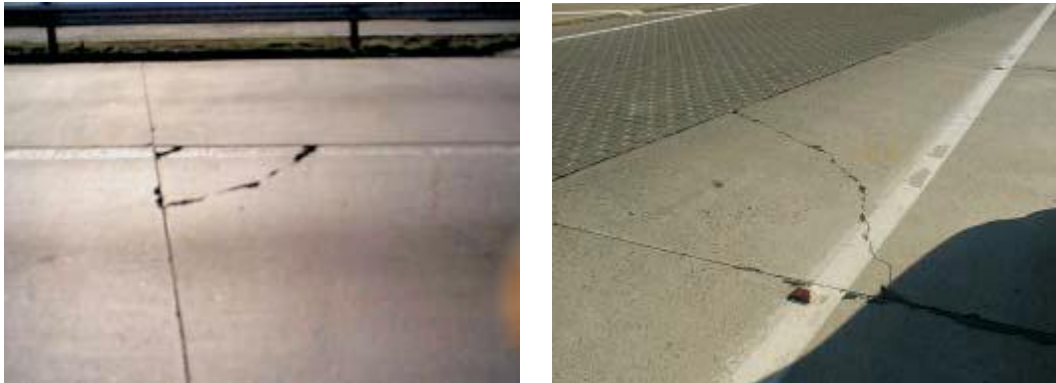
Figura 2.5: Grietas de esquina
