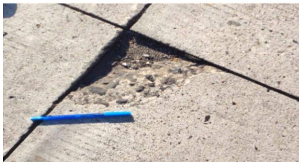
Figura 5.5: Despostillamiento de esquina de severidad media.
