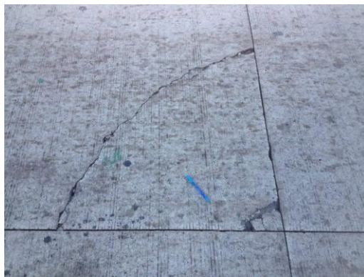
Figura 5.6: Grieta de esquina de baja severidad.
