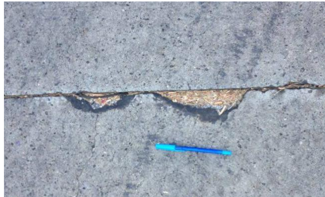
Figura 5.4: Despostillamiento de junta de severidad baja y media respectivamente.
