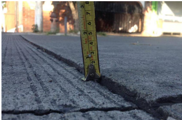
Figura 5.3: Escalonamiento de junta de baja severidad, encontrado en la vía.
