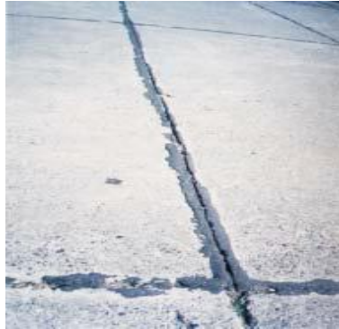
Figura 2.2: Deterioro de las juntas
