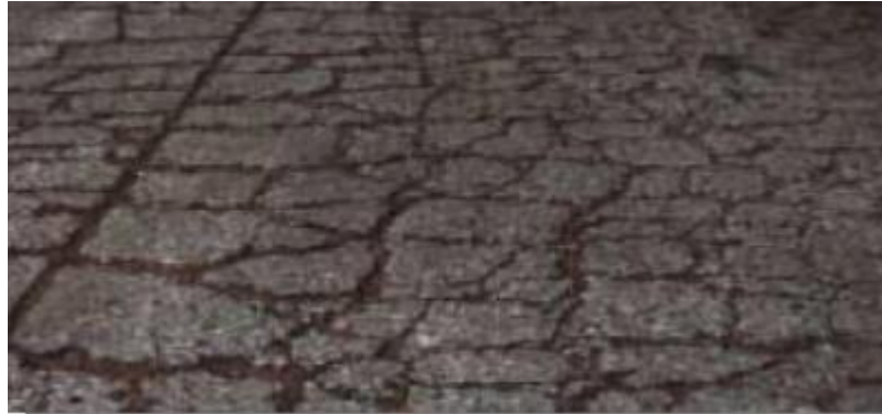
Figura 2.8: Agrietamiento tipo mapa
