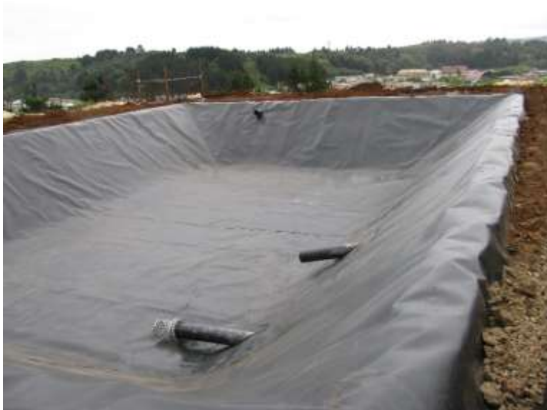
FIGURA 2. 17 EJEMPLO DE GEOMEMBRANAS PUESTAS EN OBRAS. Fuente: Manual de Diseño con Geosintéticos.
