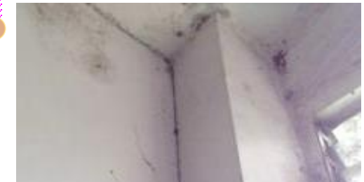
Imagen N° III-7- Daños en Sistema estructural
