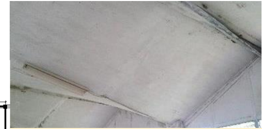
Imagen-III-23- Detalle de luminarias y techo.
