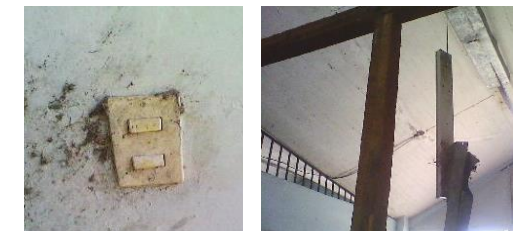
Imagen-III-26- Detalle de luminaria e interruptor
