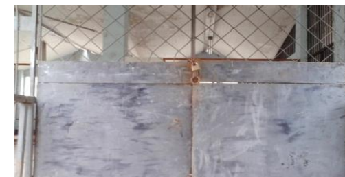
Imagen-III-40- Daños provocados por suciedad
