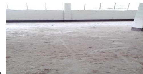
Imagen-III-37- Daños provocados por suciedad
