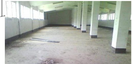
Imagen-III-28- Daños provocados por eflorescencia
