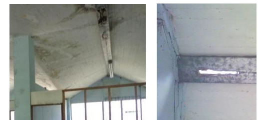
Imagen-III-30- Daños provocados por costra y oxidación
