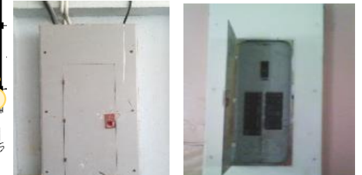
Imagen-III-20- Detalle de cajas de térmicos
