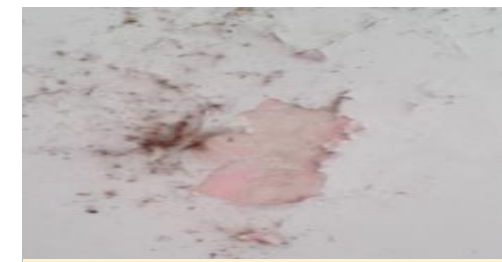
Imagen-III-39- Daños provocados por descamación
