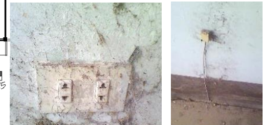
Imagen-III-24- Detalle de tomacorriente y caja de teléfono
