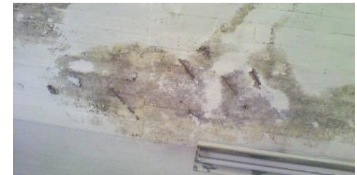
Imagen-III-29- Daños por desprendimiento.
