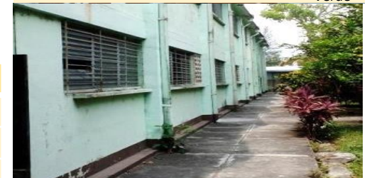
Imagen-III-14- Bajadas y tubería de aguas Lluvias del Edificio "Verde".
