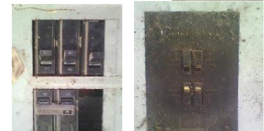
Imagen-III-25- Detalle de cajas térmicas 2do Nivel
