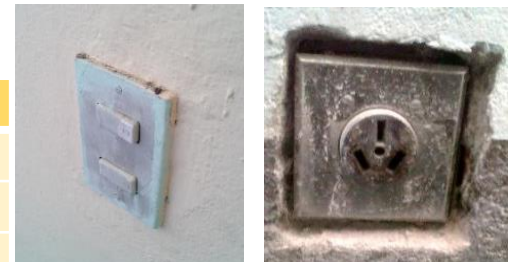
Imagen-III-21- Detalle de interruptor y tomacorriente trifilar
