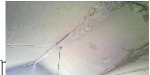
Imagen-III-27- Daños provocados por humedad
