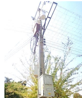
2. Poste con transformador
