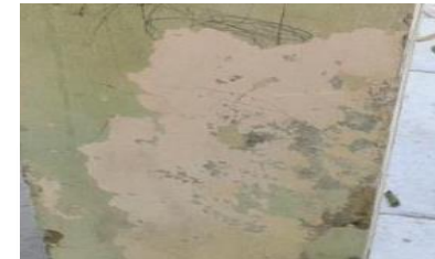
Imagen-III-41- Pared repellada, afinada y pintada deteriorada por humedad.
