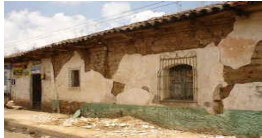
Imagen 77: Edificación con Daños Parciales Fuente: Archivo Propio
