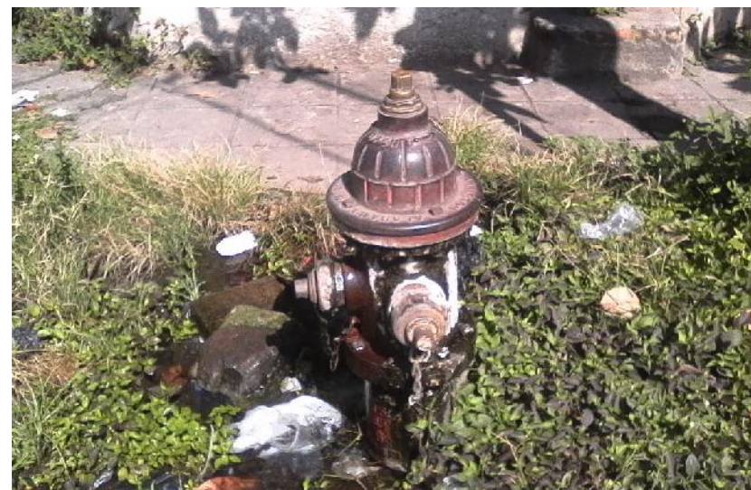
Imagen 97: Hidrante en mal estado Fuente: Archivo Propio
