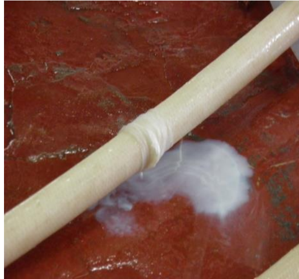
Figura A-5. Fugas en mangueras.
