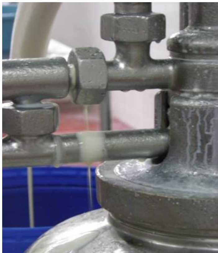
Figura A-6. Fugas en equipos.
