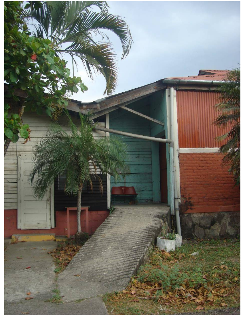
Fotografía 9. Dos edificaciones. A la derecha oficinas, en las cuales se aprecia la utilización del sistema constructivo de madera. A la izquierda bodegas, construidas utilizando el sistema mixto; sus cimientos son de piedra y un muro a media altura de ladrillo de barro para luego culminar con recubrimiento de lámina. Fuente: Elaboración propia..
