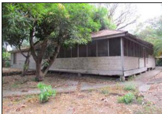
Antes oficina de mantenimiento actualmente fuera de uso. Sistema constructivo de madera, emplazada sobre pilotes.
