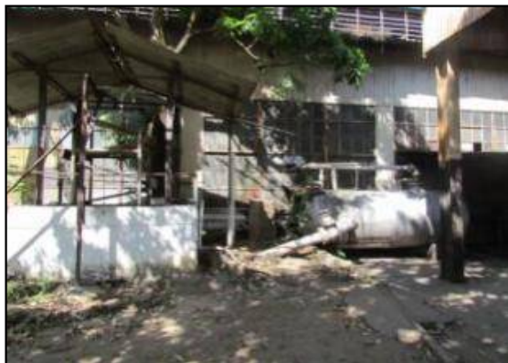
A la derecha enfriador de agua, a la izquierda tanque de compresor.
