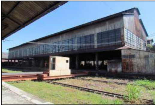
Vista de la mesa de transferencia y al fondo la nave Nº 2.
