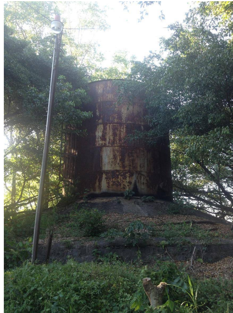
Fotografía 52 TANQUE DE COMBUSTIBLE DIESEL. Fuente: Visita de campo
