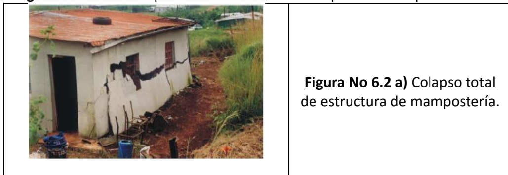
Figura No 6.2: Daños provocados a edificaciones por suelos expansivos.
