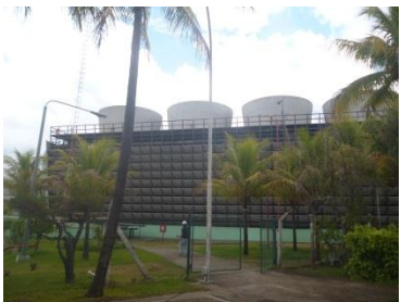
Imagen 10: torres de enfriamiento
