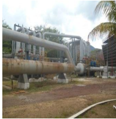
Imagen 12: Tubería de acarreo de vapor
