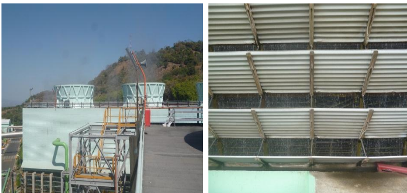
Imagen 13: Sistema de enfriamiento
